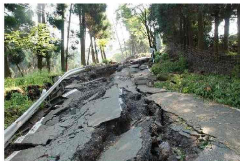
(被害を受けた南阿蘇町内の道路)
